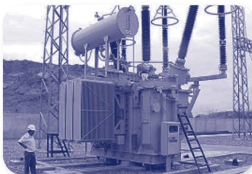
Figura 9. Transformador de potencia
