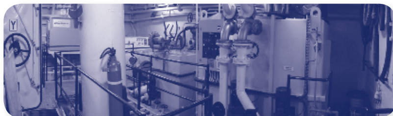
Figura 7. Equipo crítico a bordo del Buque Escuela ARC “Gloria”: Planta de aguas residuales
