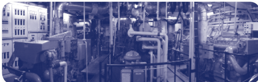
Figura 4. Cuarto de Máquinas del Buque Escuela ARC "Gloria" con sus diferentes equipos principales y auxiliares
