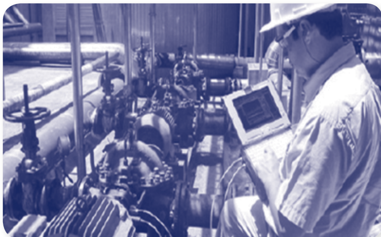
Figura 10. Verificación de variables en funcionamiento de motobombas
